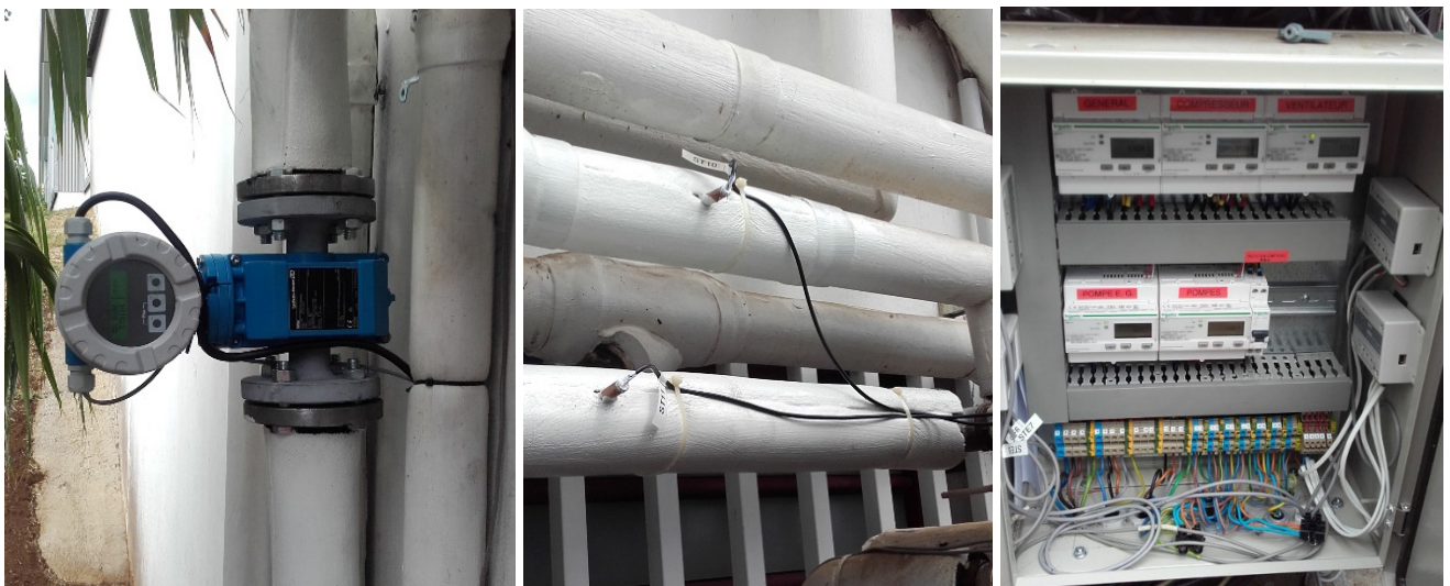
Figure 5 : Vue de quelques exemples d'équipements de comptage (débitmètre, doigts de gant pour les sondes de température, compteurs électriques)
