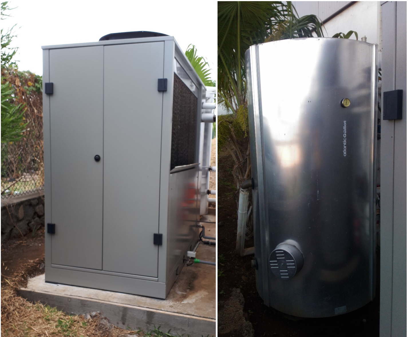
Figure 3 : Vues de l'installation de climatisation solaire
