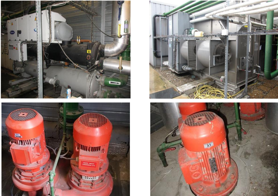
Figure 9 : Production confort 3x575kW froid : groupe froid (haut gauche), tour de refroidissement (haut droite), pompe double d'un circuit condenseur (bas, gauche), pompe double d'un circuit évaporateur (bas, droite).
