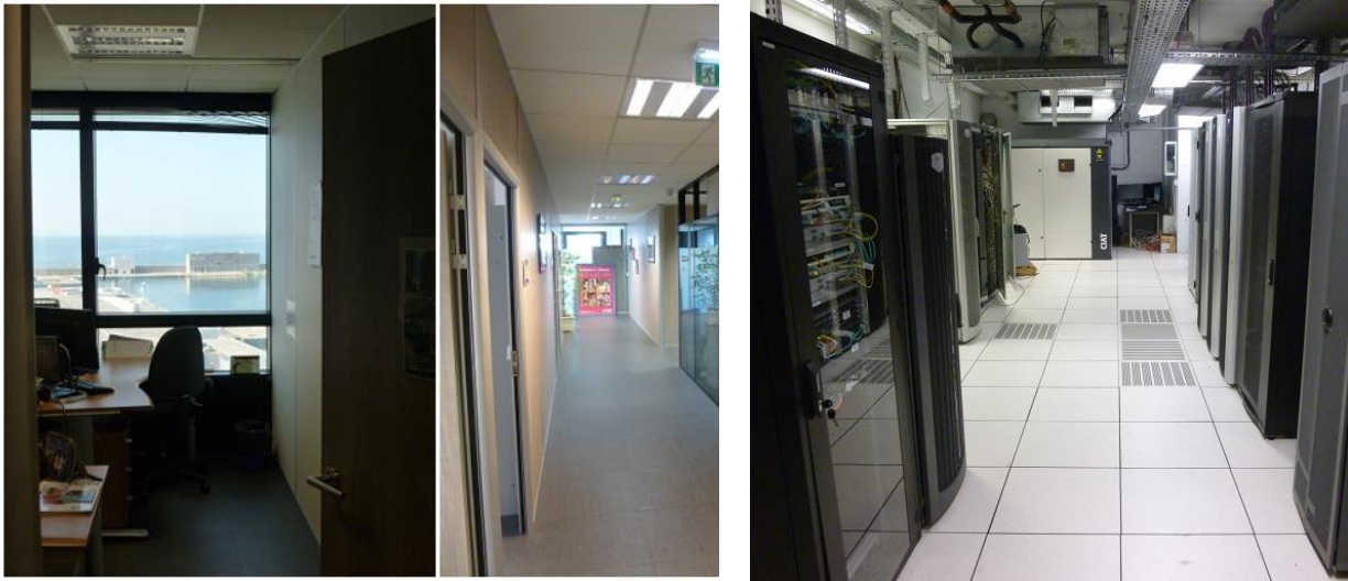
Figure 5 : Situation et vues du bâtiment Mirabeau2 à Marseille (au milieu à droite : aquarium de l'accueil au RDC ; en bas à gauche : bureau et couloir courants ; en bas à droite : local informatique principal abritant les serveurs informatiques du département).
