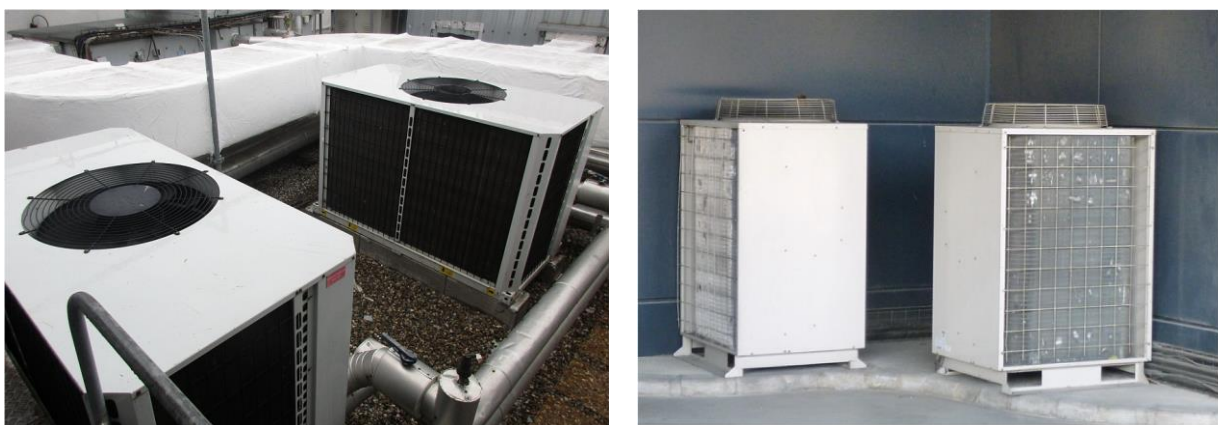
Figure 12 : Photographies des groupes de production « informatique » Carrier (eau glacée, 2x80kW froid , toiture) à gauche et des groupes de secours Hitachi (eau glacée, niveau 3) à droite.
