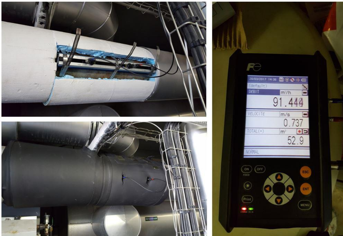
Figure 19 : Pose d'un débitmètre à ultrason portatif par Enertech sur le Mirabeau2 (ici production de froid confort).
