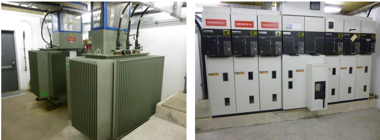
Figure 6 : Installation électrique du site : à gauche les transformateurs, à droite les cellules électriques haute tension.
