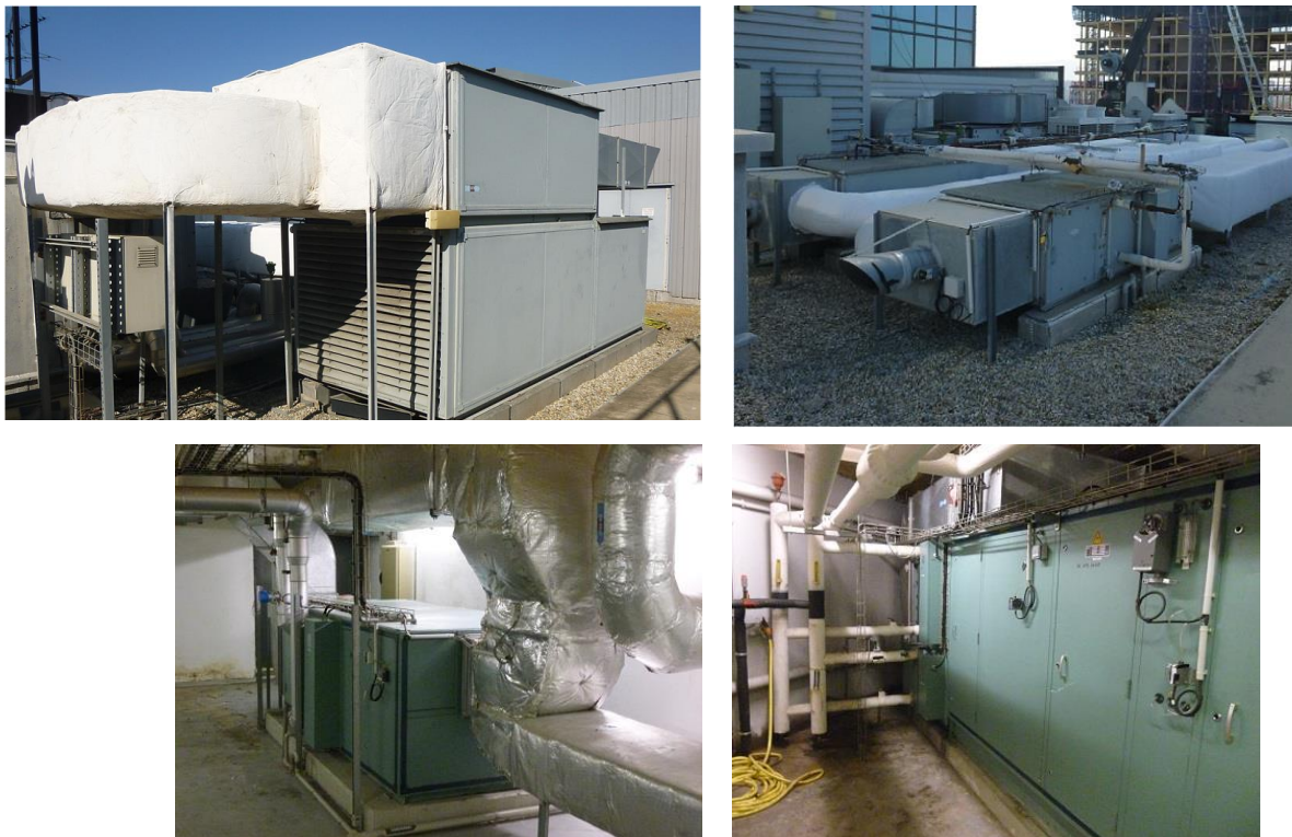
Figure 18 : Photographies de quelques CTA. De haut en bas et de gauche à droite : CTA bureaux sud, CTA salle verte, CTA Fitness et CTA Agence.
