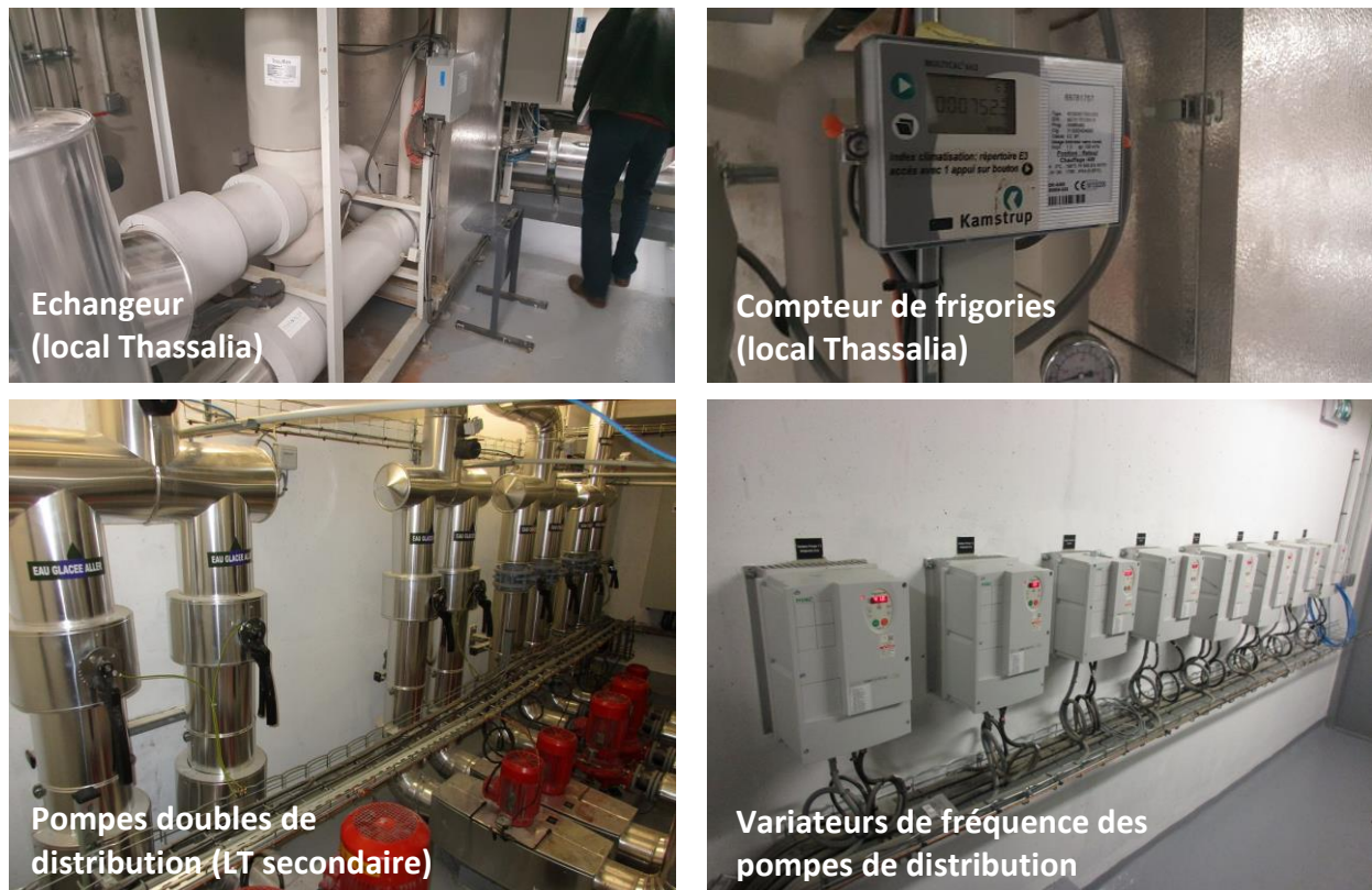
Figure 9 : Sous-station Thassalia et local technique secondaire du bâtiment Golden Tulip.
