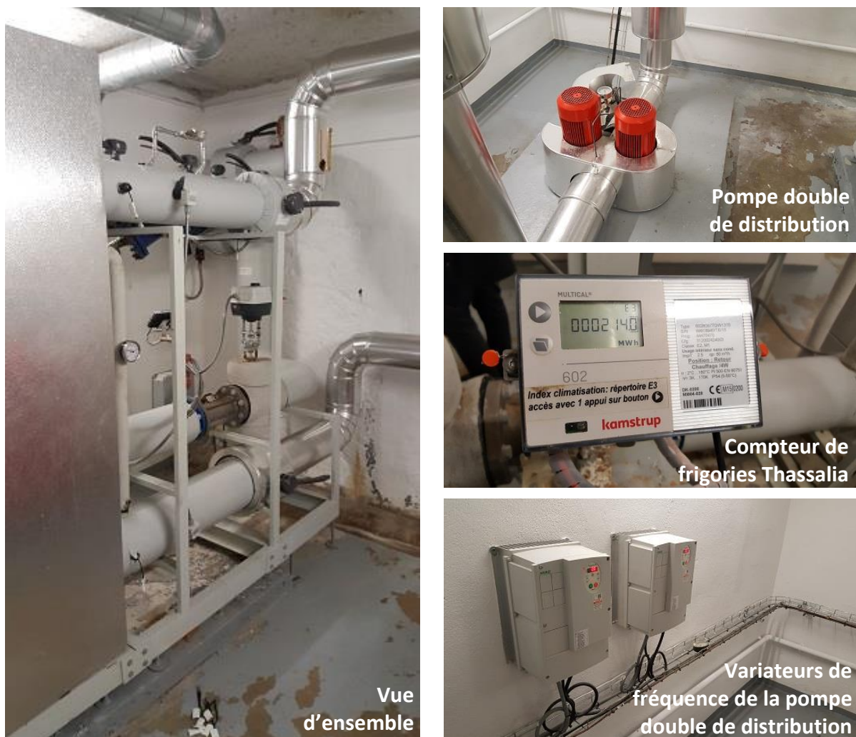
Figure 8 : Sous-station Thassalia du bâtiment Calypso.
