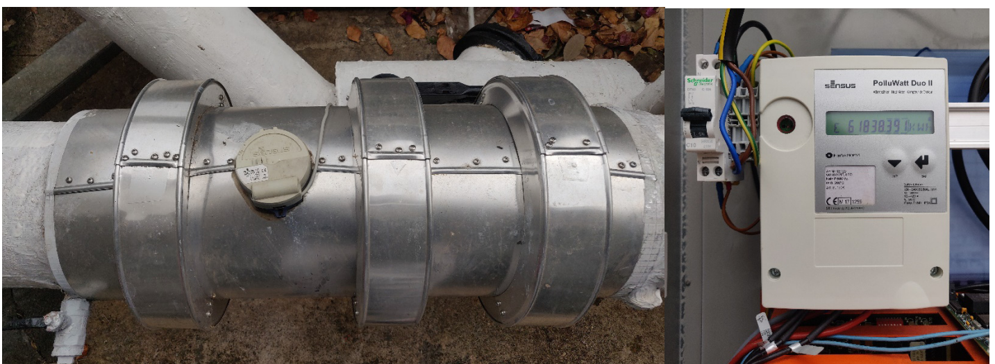
Figure 8 : Vue du compteur de frigories installé sur le réseau EG
