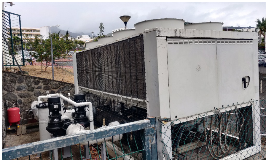
Figure 5 : Vue du groupe de production de froid
