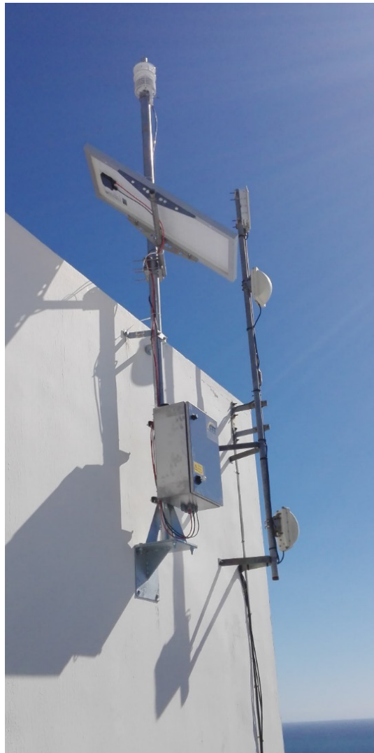
Figure 7 : Vue de la station météo installée sur le toit de la bibliothèque Droit et Lettres
