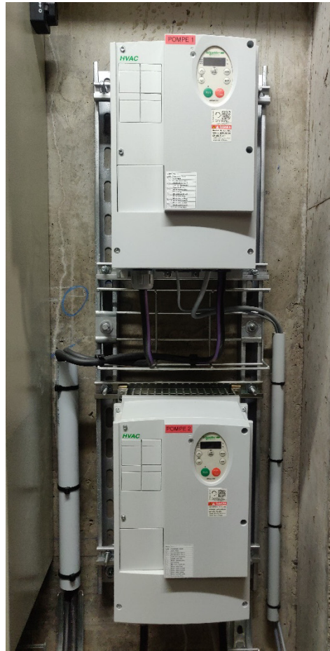
Figure 31 : Vue des coffrets des variateurs de fréquence installés
