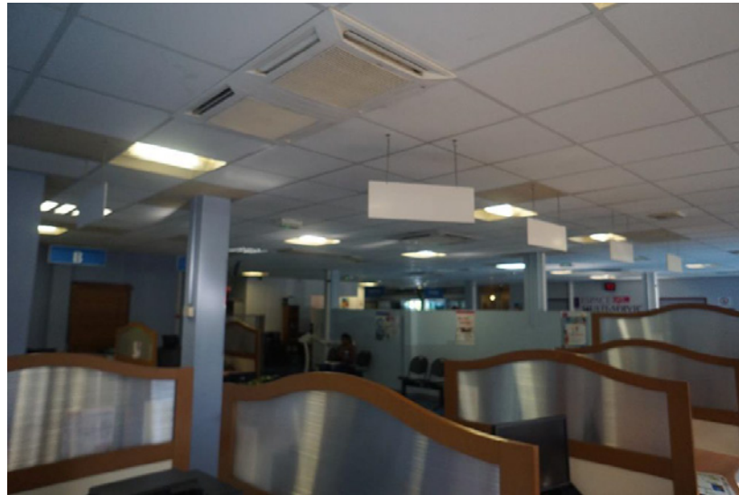
Figure 9 Cassettes de climatisation de l'espace public
