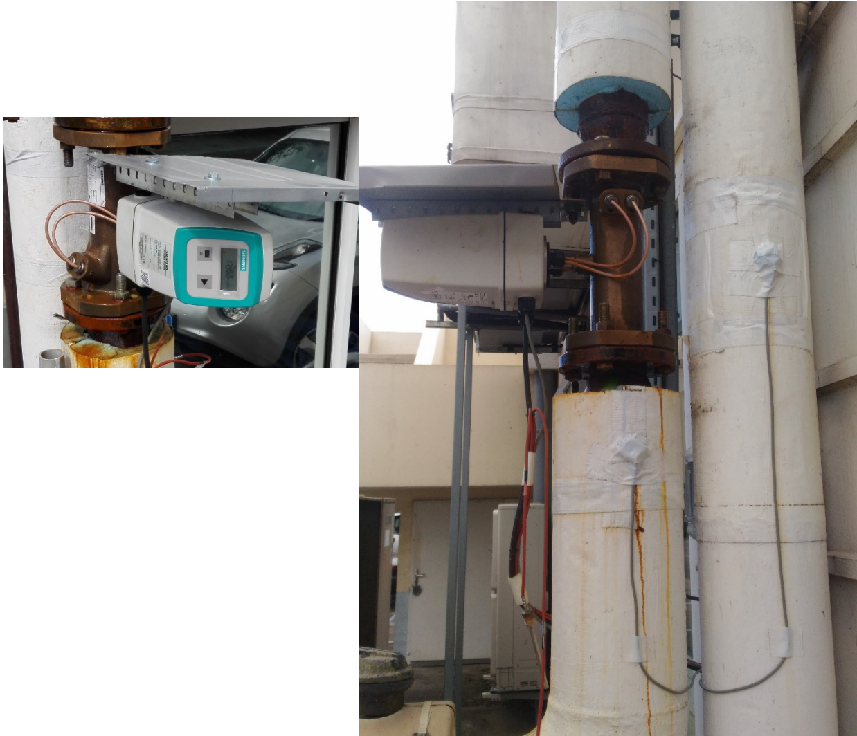
Figure 7 : Vue du compteur de frigories installé sur le réseau EG
