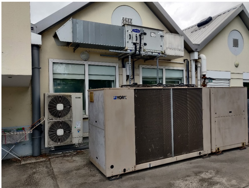
Figure 5 : Vue du groupe de production de froid
