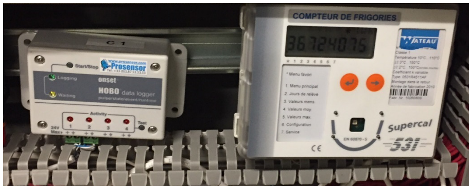
Figure 7 : Vue du calculateur du compteur de frigories en place sur le réseau EG
