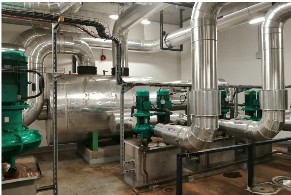
Figure 5 : Vue de la salle des machines
